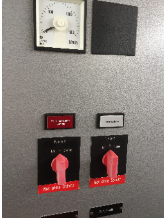
Eine Pumpe ist defekt, ausser Betrieb
